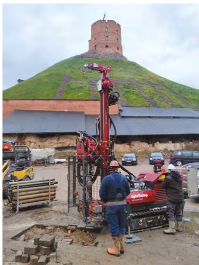
2 pav. Gręžinys įrengiamas vibraciniu sukamuoju būdu, Arsenalo g. 1, Vilnius, 2021 m. (UAB „Geotestus“).
